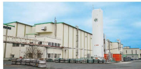
サテライト設備(一関工場)
